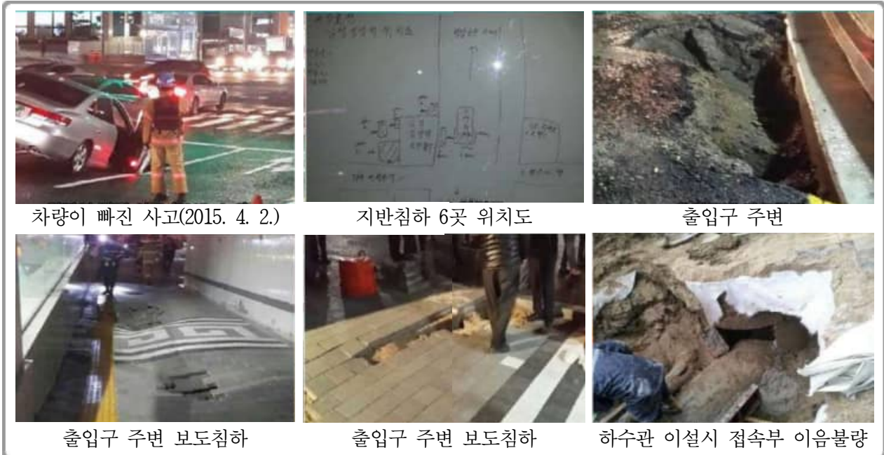
그림 3-5. 삼성중앙역 지하매설물 파손에 의한 지반침하 발생 사례
