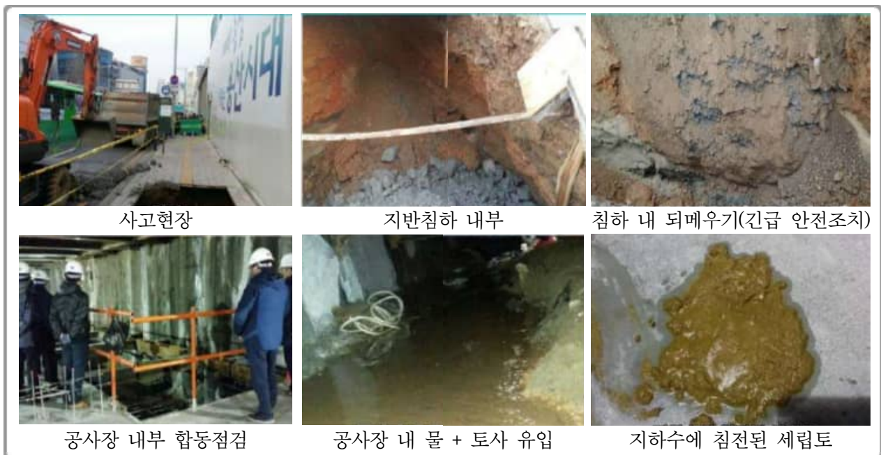
그림 3-14. 용산역 앞 신축공사장에 의한 지반침하 발생 사례
